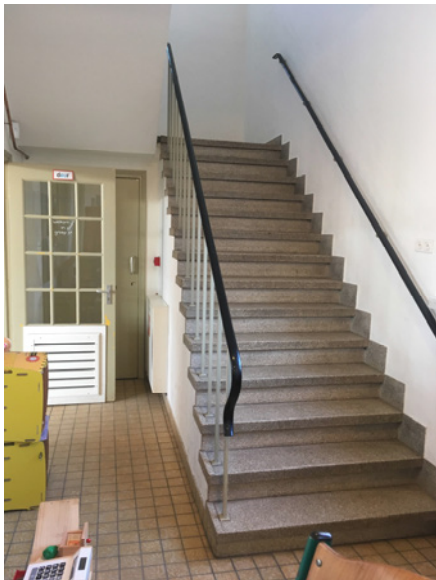
Twee opnames van het interieur, links de gang en rechts het trappenhuis (2019: afdeling Erfgoed).
